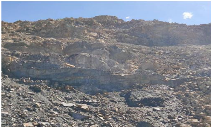
照片 2-2 1 号露天采坑南侧边坡崩塌地质灾害点
